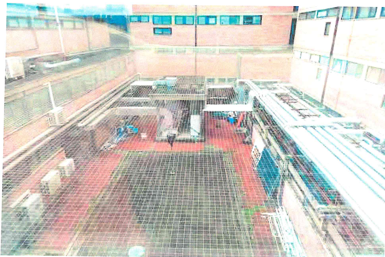
Foto aerea del sistema anti-intrusione ultimato
